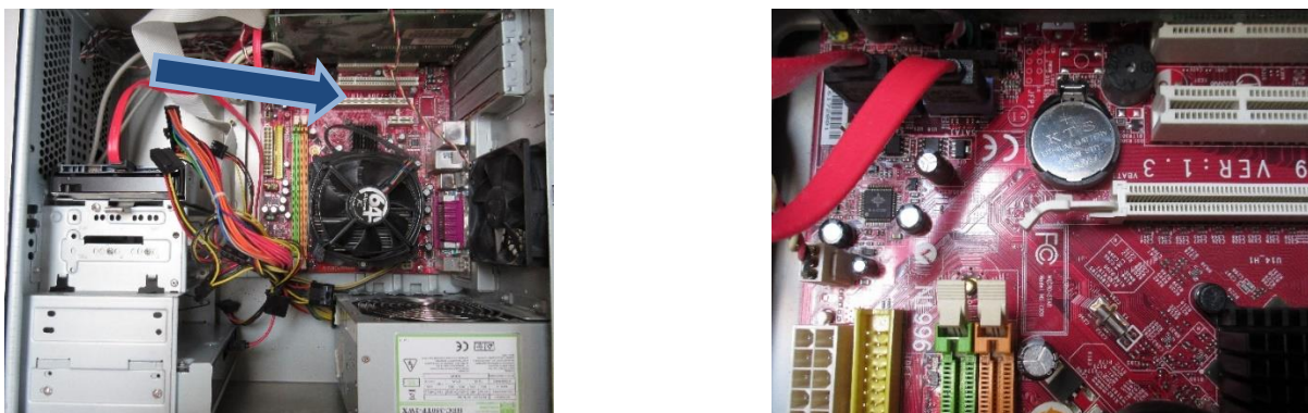
Abbildung 14: Stützbatterie Typ CR 2032, 3 Volt auf PC-Platine
